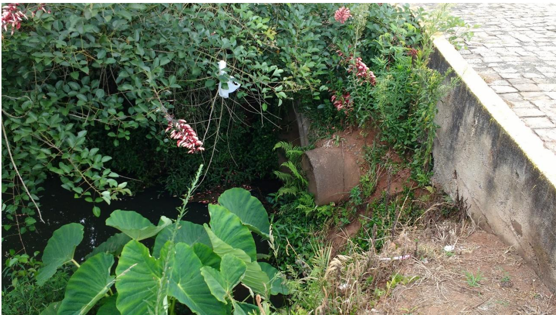
Encontro do Córrego com a Rua Santa Catarina (Jusante) – 2 – 27°09'39.3"S 50°28'09.0"W Obra de Prevenção: Execução de Galeria em Concreto Armado
