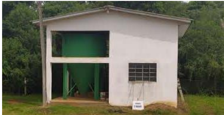
Figura 37 - Tratamento físico-químico inoperante.
